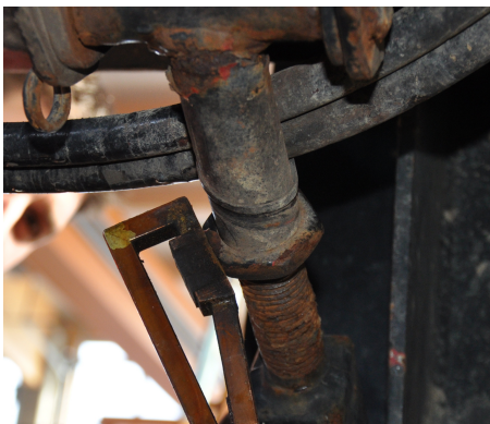
Bild: Verrostete Schraubverbindungen öffnen ganz ohne zu Glühen - eine Frage der Leistung und vor allem der Wirtiefe!
