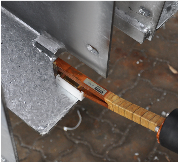
Bild: Das 'Zink-Bügeleisen' - der Induktor mit Teflonkappe und passend reduzierter Leistung bringt Zinkreste sofort zum Schmelzen
